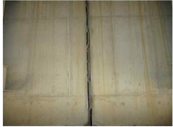
A1 실란트 파손(6.0m) - 22년 상반기
