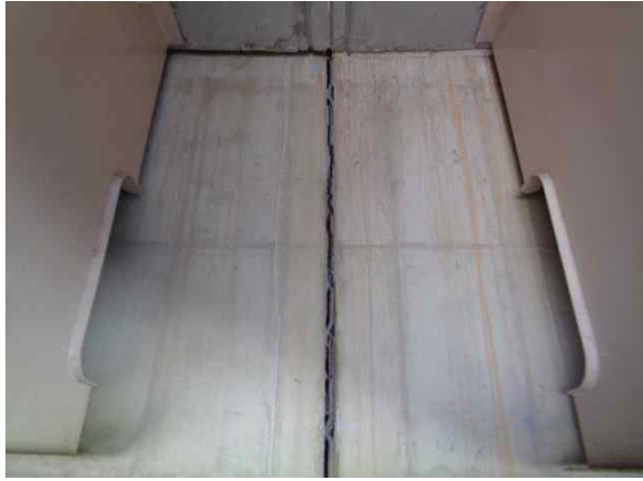
A1 실란트 파손(6.0m) - 금회
